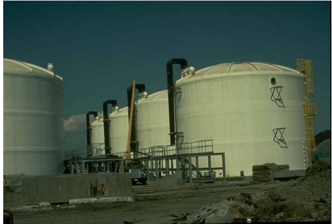
Tanques de Neutralização de Água Residual Diâmetro de 15 m e altura de 10 metros Volume: 1,75 milhões de litros Operação: Desde 1988. Temperatura: até 90°C
