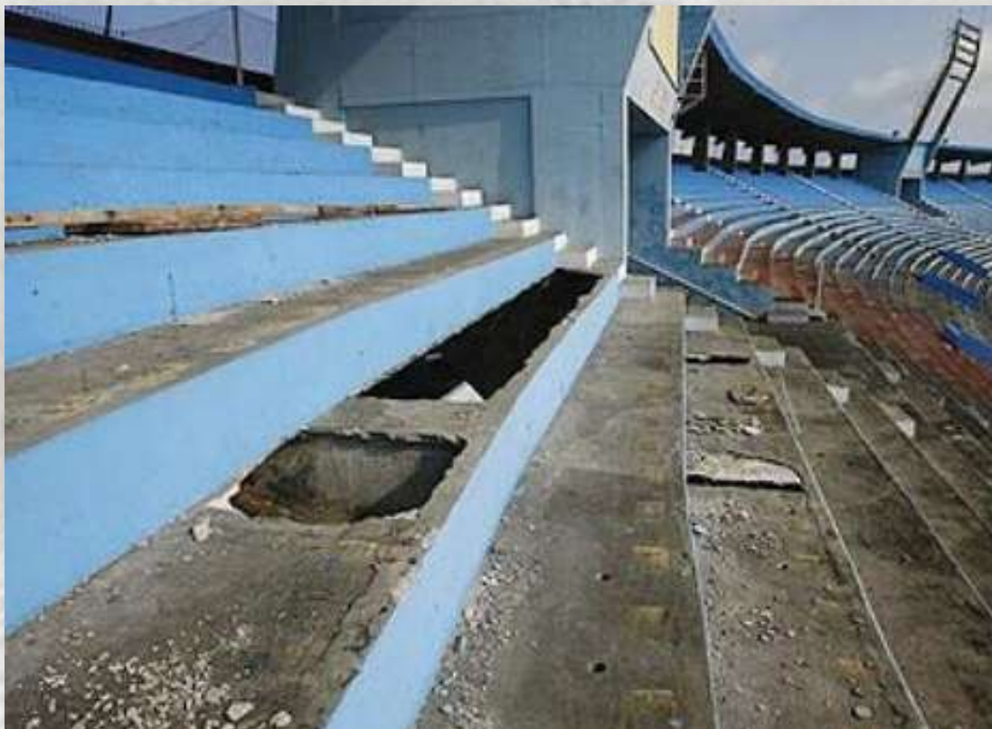
Queda de arquibancada no estádio da Fonte nova
